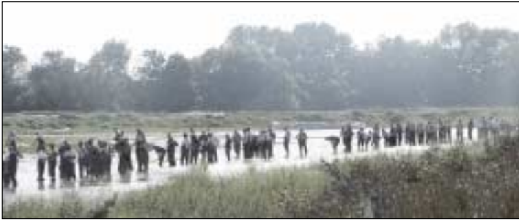
Verbau einer Sickerstelle mit massivem Wasseraustritt am Ohredeich durch Kameraden der Kreisfeuerwehrebereitschaft - teilweise stehen die Helfer knietief im aufgeweichten Boden
